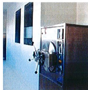
Couloir gris : sortie autoclave et hublots de surveillance
