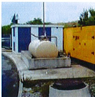
Le groupe électrogène, le transformateur et les groupes-froid.
